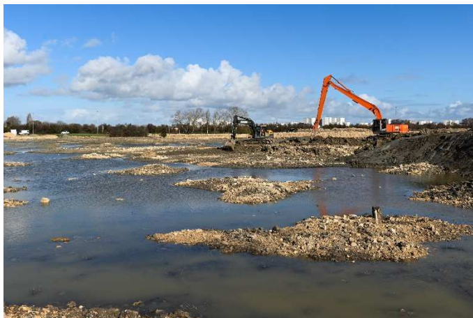
Travaux du Marais de Tasdon à la Rochelle Photo Julien Chauvet – Ville de La Rochelle
